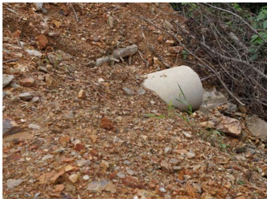
照片 4.1-2 道路排水涵管
